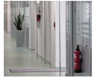
Feuerlöscher dienen zur Bekämpfung von entstehenden Bränden und müssen jederzeit funktionsfähig sein
