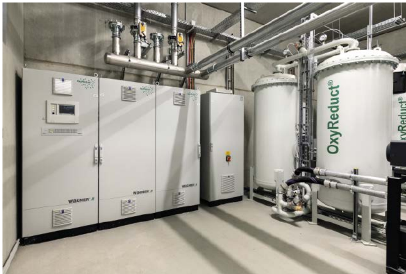
Die OxyReduct-Anlage und das Brandfrüherkennungssystem Titanus sorgen für ganzheitlichen Brandschutz im gesamten Lager
