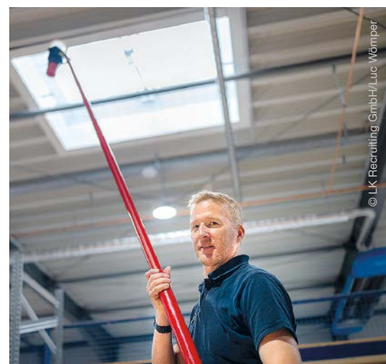
Richard Langen bei der Melderprüfung
