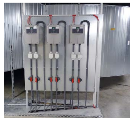
Um den Fertigungsbereich bestmöglich zu schützen, überwacht Securiton Deutschland diesen im Varta-Produktionswerk Nördlingen mit rund 170 Ansaugrauchmeldern (SecuriRAS ASD)
