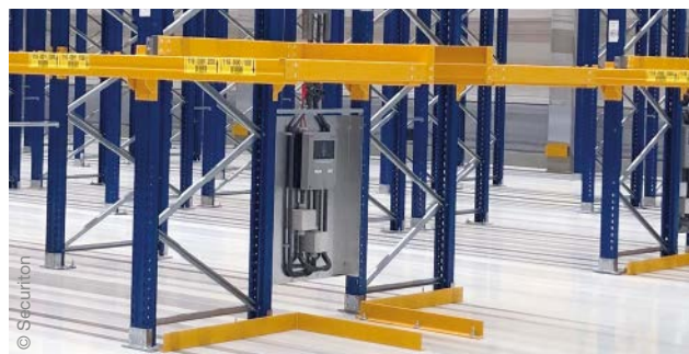
Brandschutz im Hochregallager von Securiton
