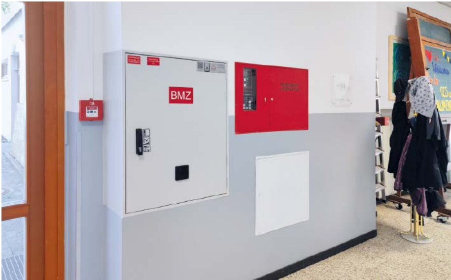
Das Gehäuse der Brandmelderzentrale ist in einem feuerfesten Gehäuse untergebracht
