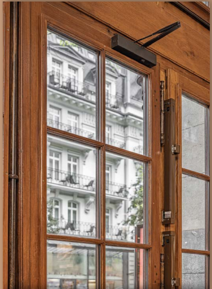
Der Kettenantrieb „Powerchain“ öffnet große und schwere Fensterelemente im Bahnhof
