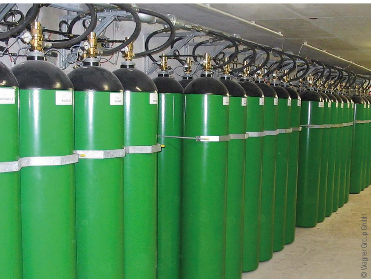
Ein Gaslöschsystem sorgt im Brandfall für schnelle und rückstandsfreie Löschung
